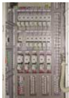
Рис. 2. Монтаж аппаратуры в шкафах НКУ выполнен на реечные конструкции
