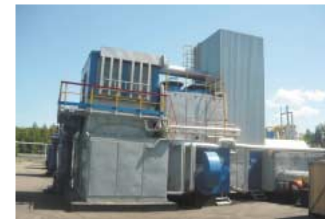
Фото 5. ГПА-Ц-6,3/56М до капитального ремонта
