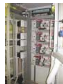
Рис. 9. НКУ для управления четырьмя двигателями АВО газа мощностью 37 кВт блочно модульно конструкции
