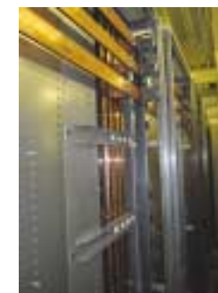
Рис. 6. Главная система сборных шин шкафов с выдвижными модулями
