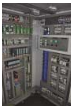
Рис. 4. НКУ смонтировано на панелях, которые установлены в блок-бокс
