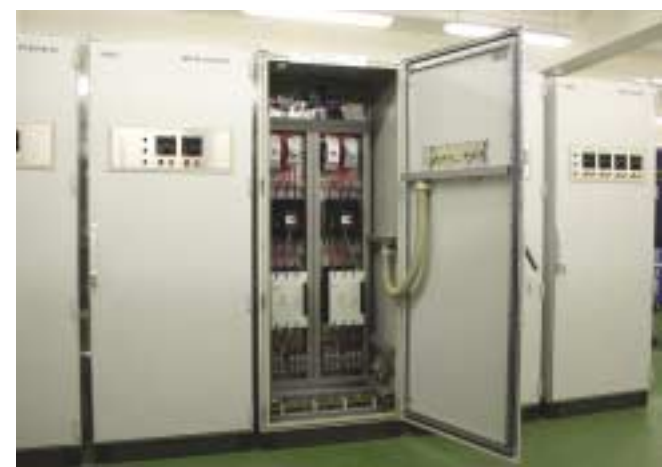
Рис. 11. НКУ для управления двумя двигателями АВО газа мощностью 37 кВт в шкафах с установкой элементов на рейки
