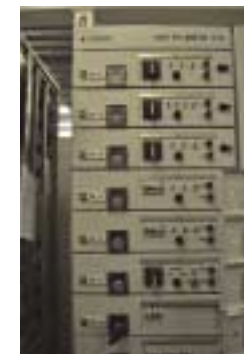
Рис. 8. Шкаф НКУ, в котором установлены модули для управления электроприемниками
