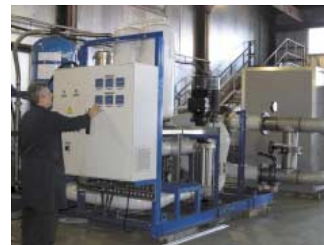
Фото 7. Насосная установка системы охлаждения СТК мощностью 1200 кВт.
