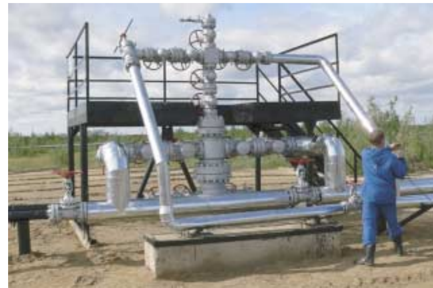
Рис. 2. Устьевая обвязка скважины месторождения Медвежье. Специальная фонтанная арматура производства ООО НПО «Нефтегаздеталь» (г. Воронеж)
