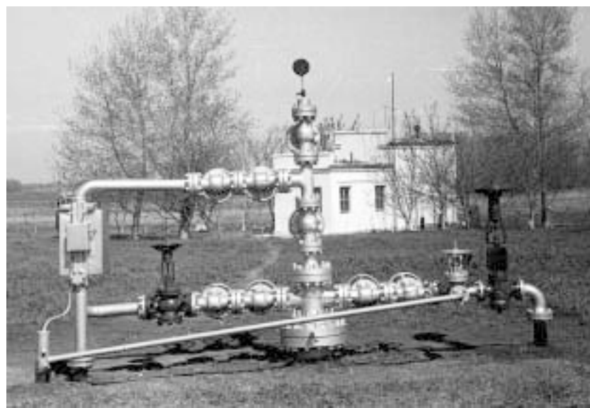
Рис. 1. Устьевая обвязка скважины № 70 Северо-Ставропольское месторождение
